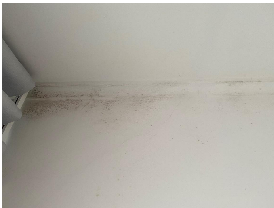
Figura 34 - Patologia encontrada na sala
