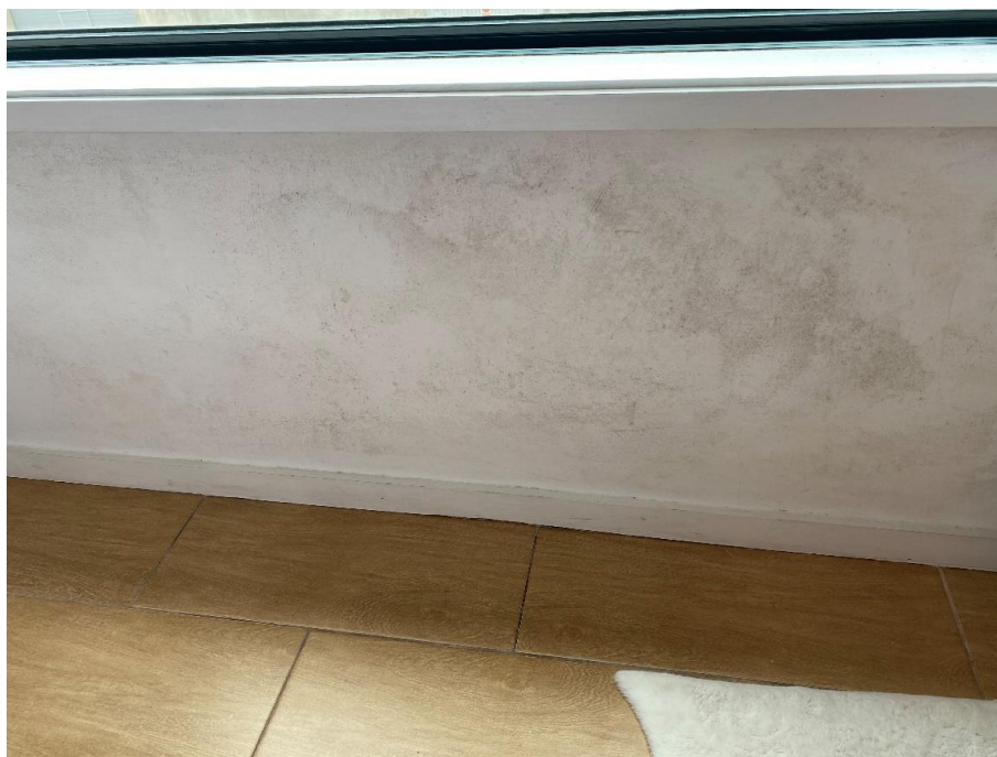
Figura 33 - Patologia encontrada no quarto
