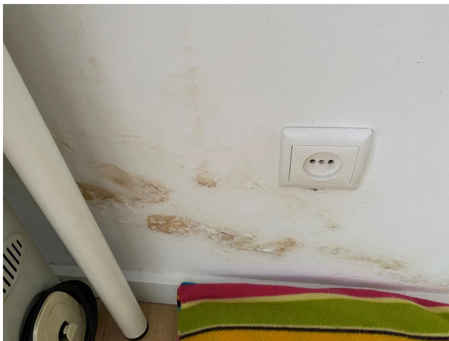
Figura 35 - Patologia encontrada no quarto
