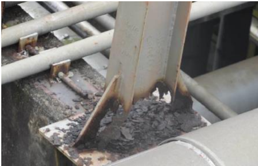
Figura 27- Base do pilar com corrosão (Fonte: empresa analisada)
