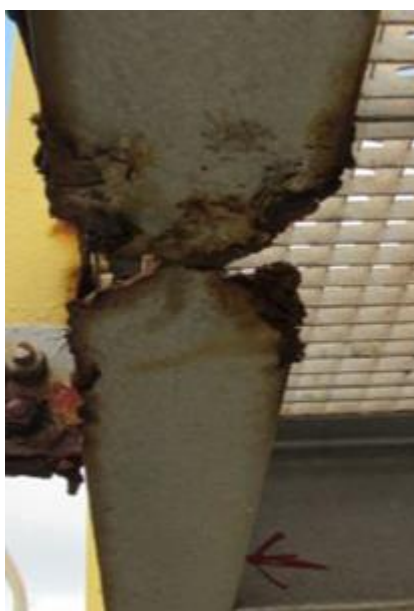
Figura 24 - Corrosão em mais de 50% do banzo inferior (Fonte: empresa analisada)
