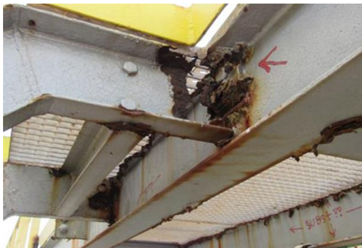
Figura 5 - Corrosão uniforme localizada (Fonte: empresa analisada)
