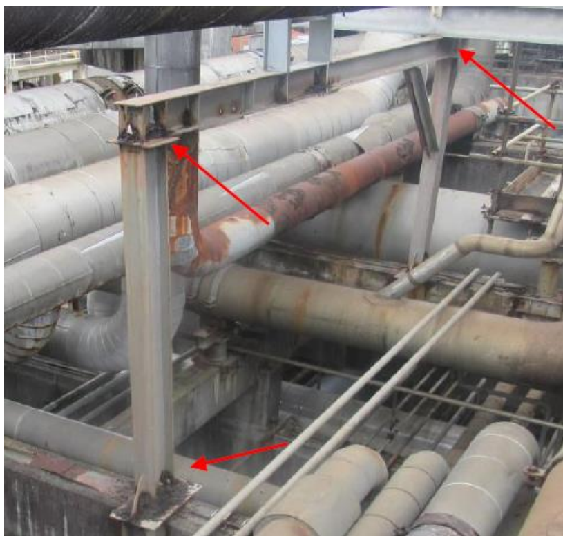
Figura 14 - Estrutura de suporte de tubulação em área industrial (fonte: empresa analisada)
