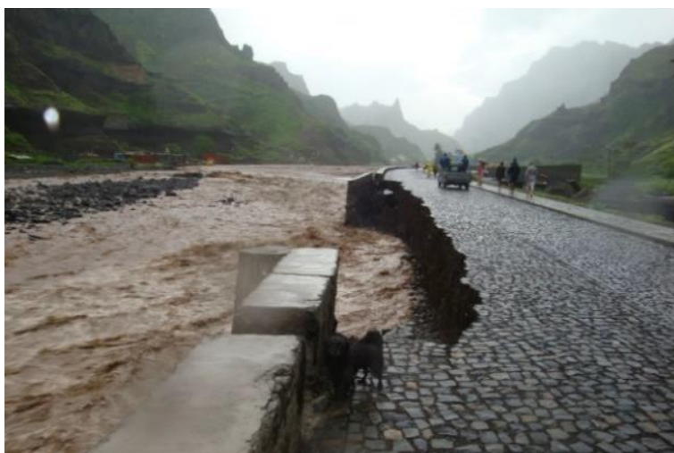
Figura 29 Danos observados na estrada de penetração do Vale da Ribeira Grande, consequência das chuvas de 23 de outubro de 2010. Foto: Arlindo Fortes.
