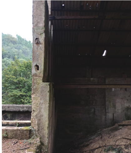
F03- Pormenor de parede de betão, onde estão presentes duas perfurações.
