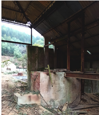
F02- Detalhe de cobertura suportada por estrutura em perfis de ferro oxidado e por paredes em betão.
