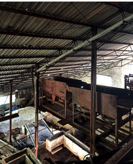
F15- Detalhe de estruturas metálicas com infraestruturas associadas.
