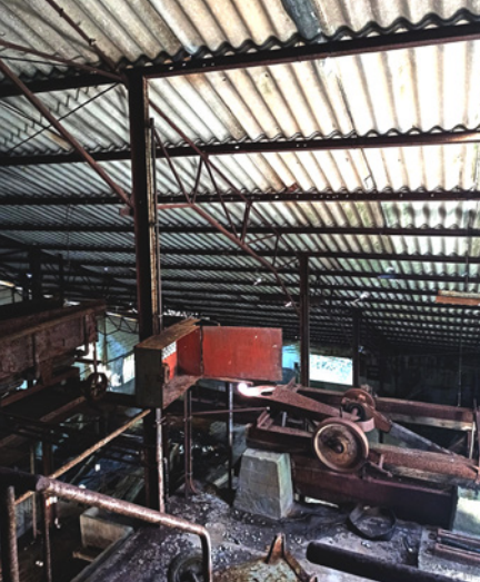
F11- Fotografia de cobertura em chapa ondulada de fibrocimento suportada por elementos em ferro oxidado.
