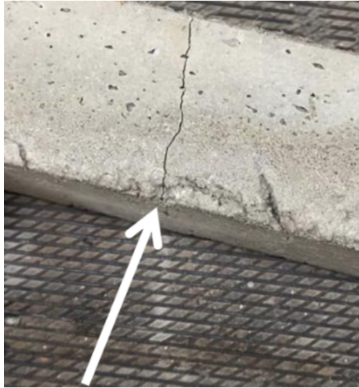
Rotura do provete do ensaio ao 14º dia
