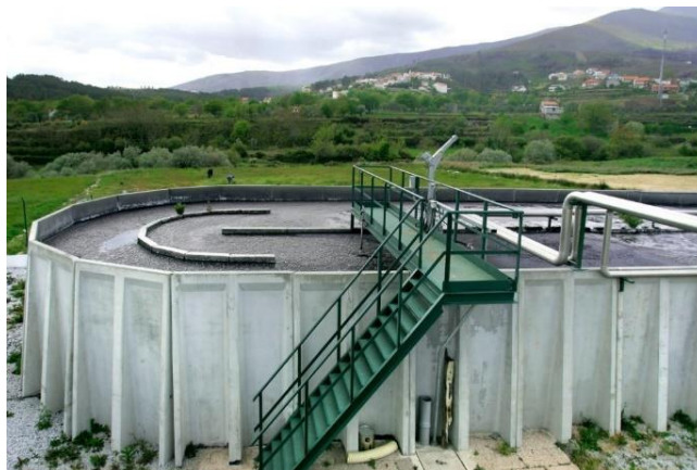
Figura 3 – Depósito de água tipo Paver
