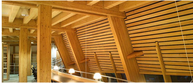
Fig.11 – Vigas em Glulam [20]
