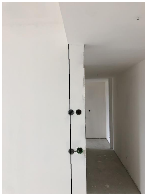
Figura 5.4 - Fotografia da interferência da guarnição da porta com os pontos elétricos (fotografia da obra em estudo)
