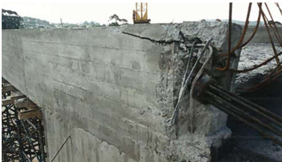
Figura 1.2. – Rotura nas zonas de ancoragem de uma cobertura de um estádio (Henriques, 2023)
