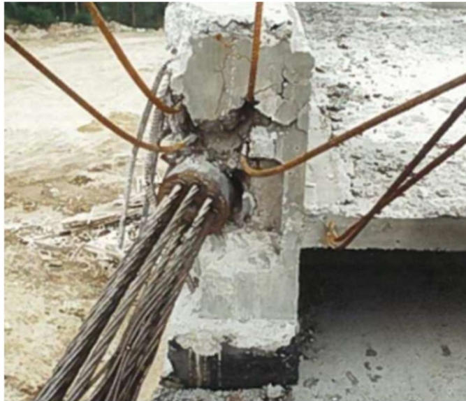
Figura 1.3. – Rotura nas zonas de ancoragem de uma cobertura de um estádio (Henriques, 2023)
