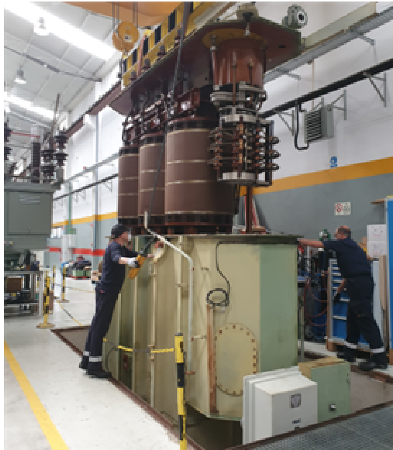
Figura 2.2: Cuba e Parte Ativa do Transformador
