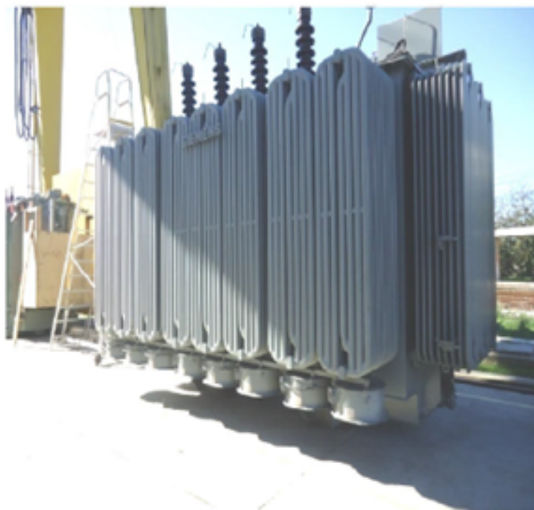
Figura 2.3: Radiadores e Ventiladores do TP
