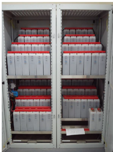
Figura 2.10: Armário de baterias [16]
