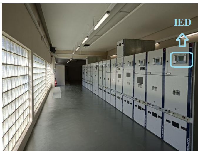
Figura 2.5: Quadro Metálico MT da Subestação de Guimarães [12]
