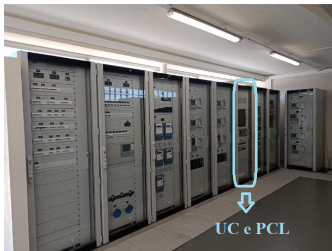
Figura 2.6: Unidade Central e Posto de Comando Local da Subestação de Guimarães [12]
