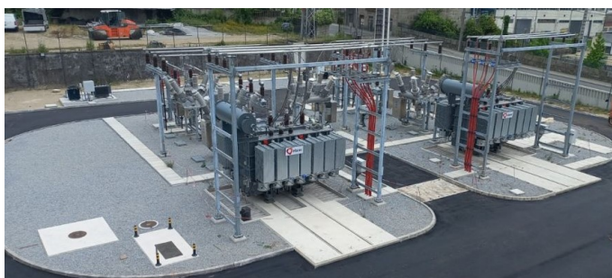
Figura 2.4: Subestação de Guimarães – céu aberto [12]
