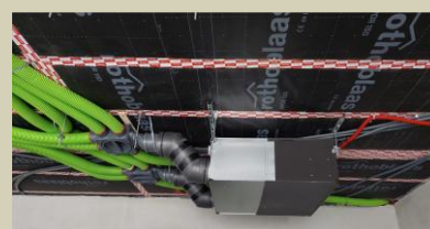
Figura 40 – Ventilador da habitação referência
