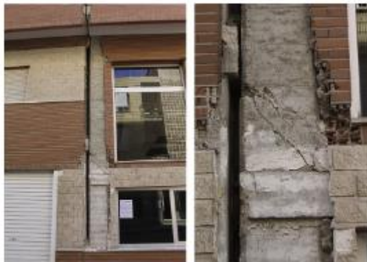
Fig.4.1. - Dano estrutural devido a efeitos de pounding (Romão, et al., 2013)
