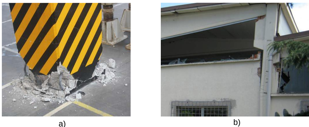
Fig. 2.40 - a) Rotura da base do pilar [43]; b) Falha de um pilar curto [42]
