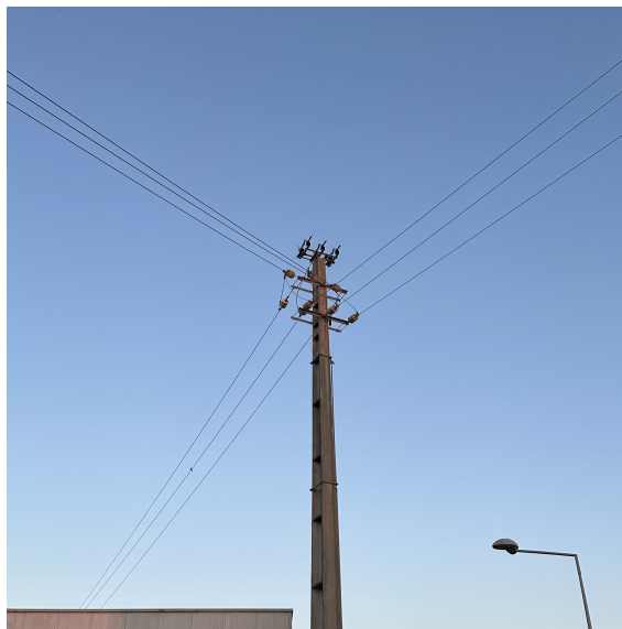
Figura 2.12: Apoio de derivação em reforço em alinhamento
