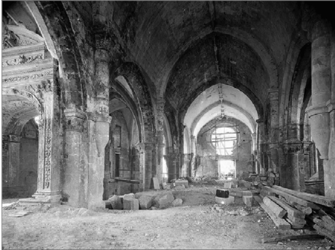
90: Obras no piso do séc. XVII e no óculo da fachada poente, cerca de 1934-35. Arquivo da DGEMN.
