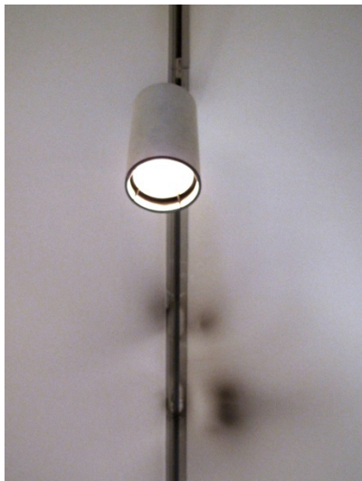
Depósito de pó no tecto.
