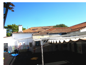
Img. 77.- vista interior da 'cobertura' improvisada
