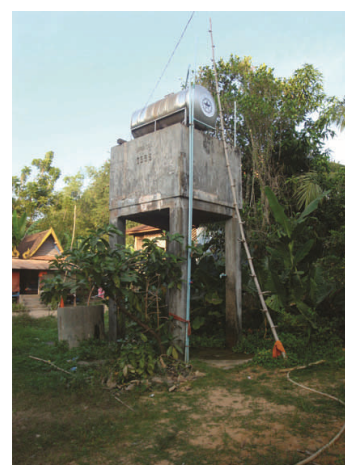
Fig.54. Depósito de água.
