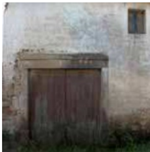
Figura 70 - Uso de barrotes de madeira para vencer os vãos das aberturas. Fonte (VARUM et al., 2005).
