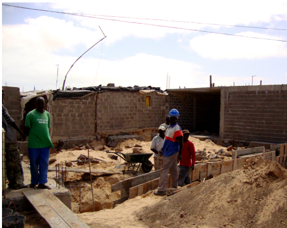
Fig.26 - Djunta D'mon : Construção ilegal de base de fundação
