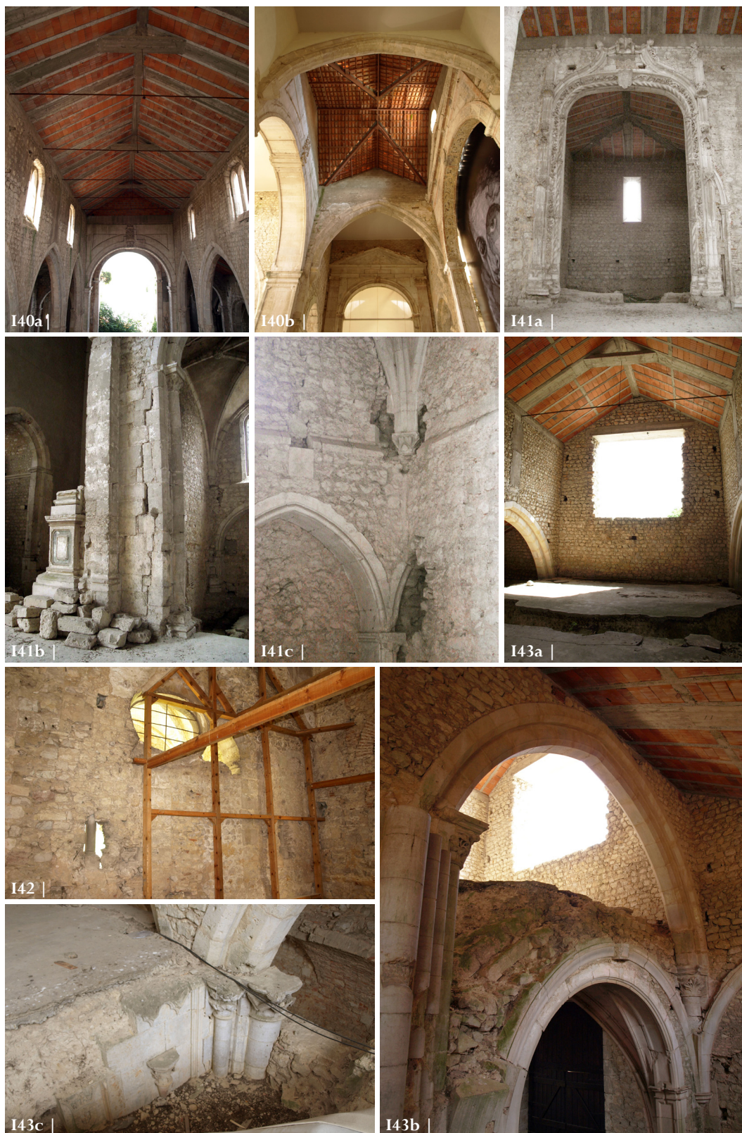
Igreja do CSF | I40a Cobertura da nave central, 2008 | I40b Cobertura da zona central do transepto, 2009 | I41a Patologia no arco da Capela de Sta Ana, 2008 | I41b Paredes junto ao arco da Capela de Sto. António, 2008 | I41c Impostas da abóbada da Capela de Sta. Ana, 2008 | I42 Escoras entre as paredes laterais da Capela das Almas, 2008 | I43a Fissura entre os dois tramos do Coro-alto, 2008 | I43b Ligação entre o arco do Coro-alto e o arco de divisão de naves, 2008 | I43c Patologias no Coro-alto: Ligação entre pavimento do Coro-alto e coluna do arco, 2009.
