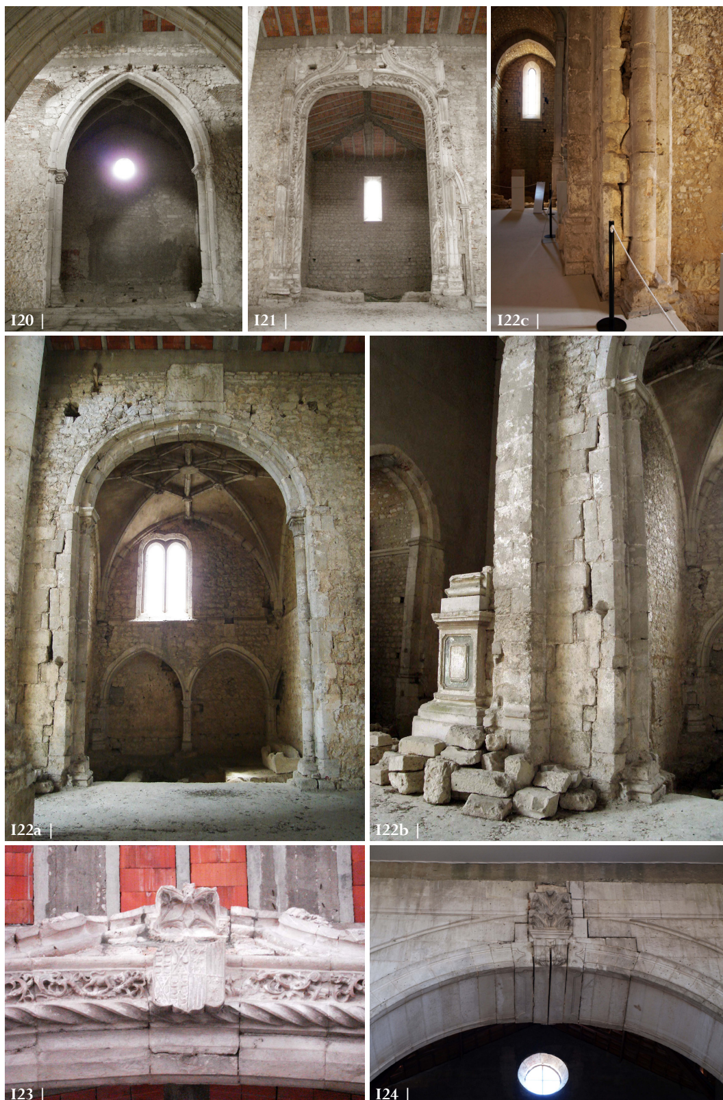
Igreja do CSF | | I20 Arco da Capela de S. Cristóvão, 2008 | | I21 Ligação entre o actual arco da Capela de Sta. Ana e os vestígios do antigo, 2009 | | I22a Patologias: Arco da Capela de Sto. António, 2008 | | I22b e c Fendas na parede de alvenaria junto ao arco da Capela de Sto. António, 2008 | | I23 Ligação entre parede de alvenaria e coluna do arco da Capela de Sta. Ana, 2009 | | I24 Patologias: Pormenor das pedras de fecho do arco de volta perfeita que separa a nave principal da Igreja do transepto, 2009.
