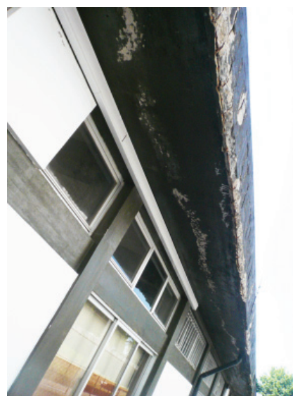
Figura 37 Patologia: betão esborrado e armadura exposta
