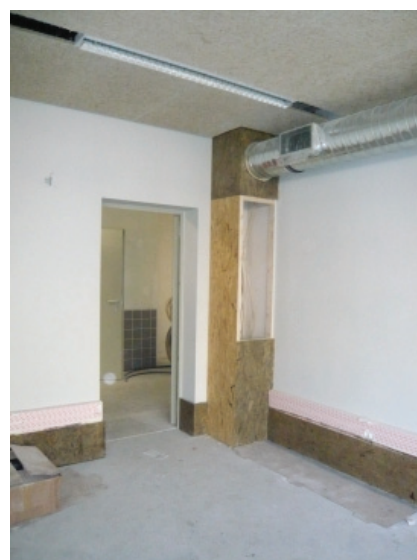
Figura 61 Rodapé e armário para quadro eléctrico e condutas de ventilação
