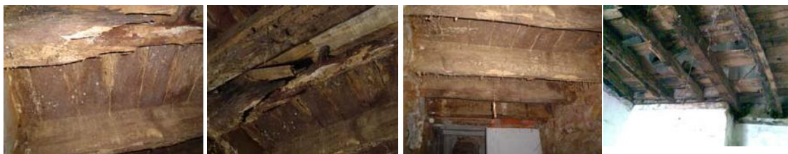
Figura 34 – Estruturas em madeira com diversas patologias no Imóvel sito na Rua Joaquim António de Aguiar nº 26 a 28 e Escadas de S. Cristóvão nº2 a 4.
