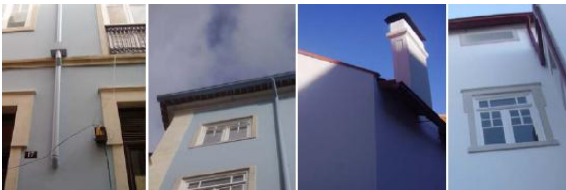
Figura 47 – Sistema de drenagem de águas pluviais, aplicado no Imóvel sito na Rua Fernandes Tomás, n.ºs 17 a 21 e 23 a 29.
