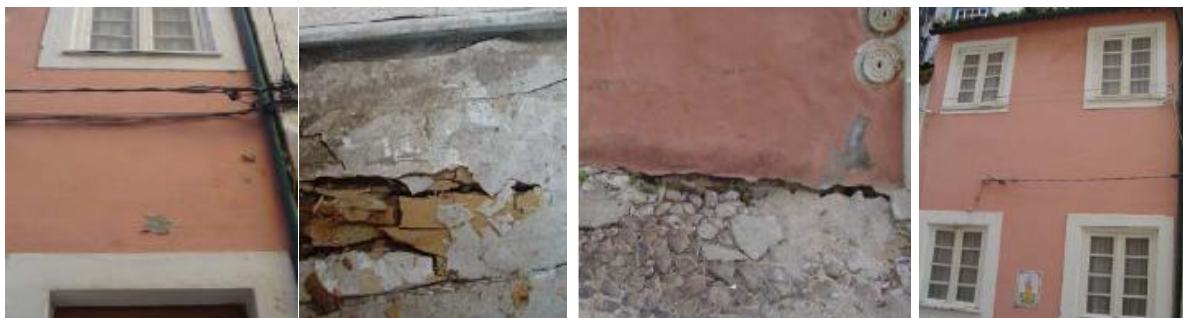
Figura 39 - Fachada exterior do imóvel sito na Rua Couraça dos Apóstolos nº62 – fendilhação, desagregação de rebocos e tinta a descascar.
