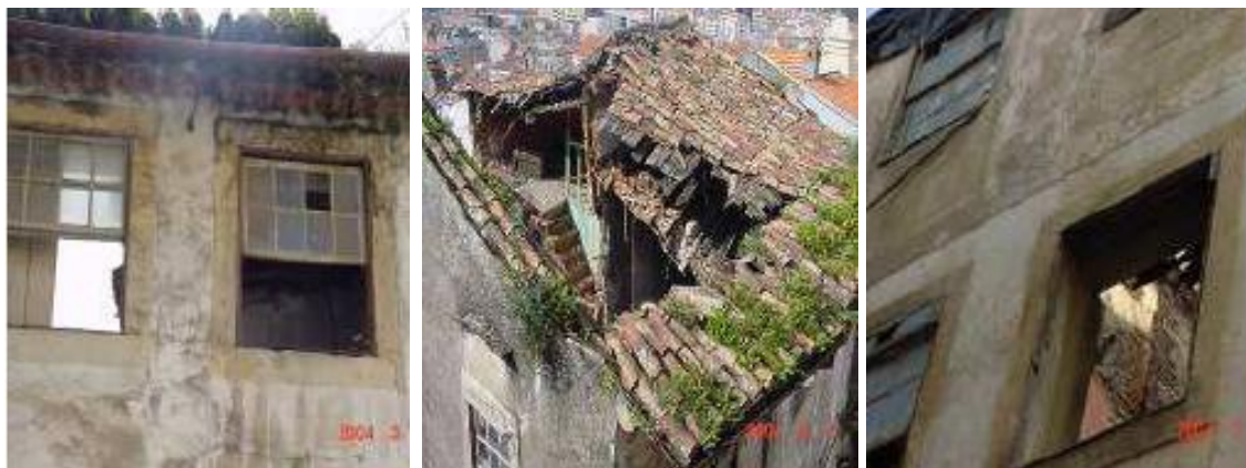
Figura 74 – Fotografias do edifício em ruína.
