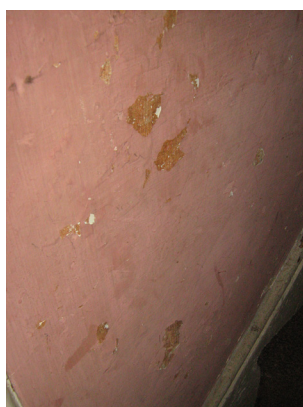
CASA 8 - DESGASTE DA PINTURA, PAREDE DAS ESCADAS
