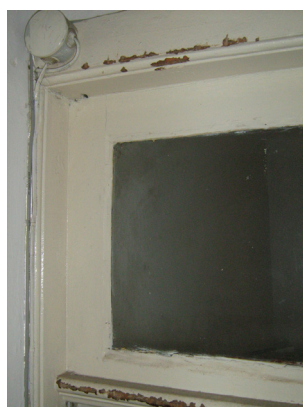
CASA 21 - DESGASTE DA PINTURA DA PORTA
