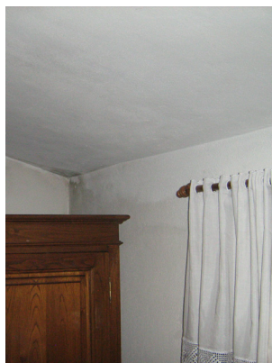
CASA 16 - HUMIDADE NO ACRESCENTO, PISO 1
