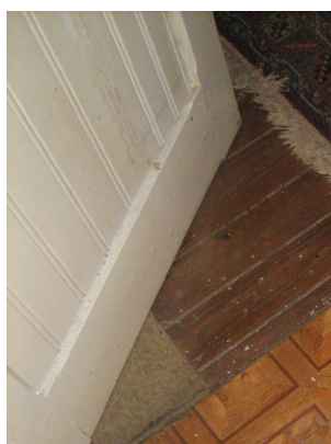
CASA 44 - DESGASTE DO PAVIMENTO
