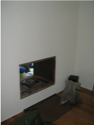
CASA 47 - RECUPERADOR DE CALOR NA SALA
