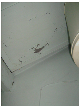
CASA 44 - DESGASTE DA PINTURA, TECTO DO WC
