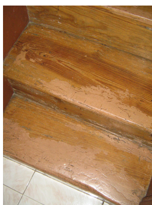
CASA 16 - DESGASTE DO PAVIMENTO
