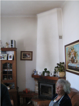
CASA 16 - RECUPERADOR DE CALOR NA SALA
