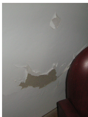
CASA 47 - DEGRADAÇÃO DA PINTURA, PAREDE MEACÃO
