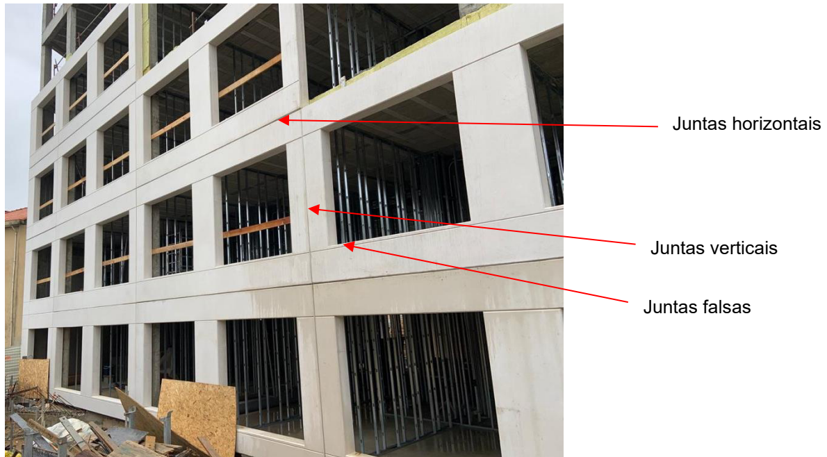
Fig. 4.11– Juntas do painel de fachada da residência de estudantes [47]
