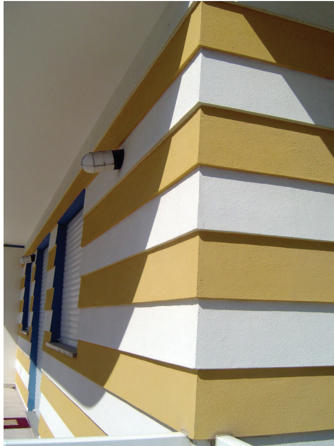
47. Detalhe onde o reboco perfaz a linguagem do tabuado de madeira.
