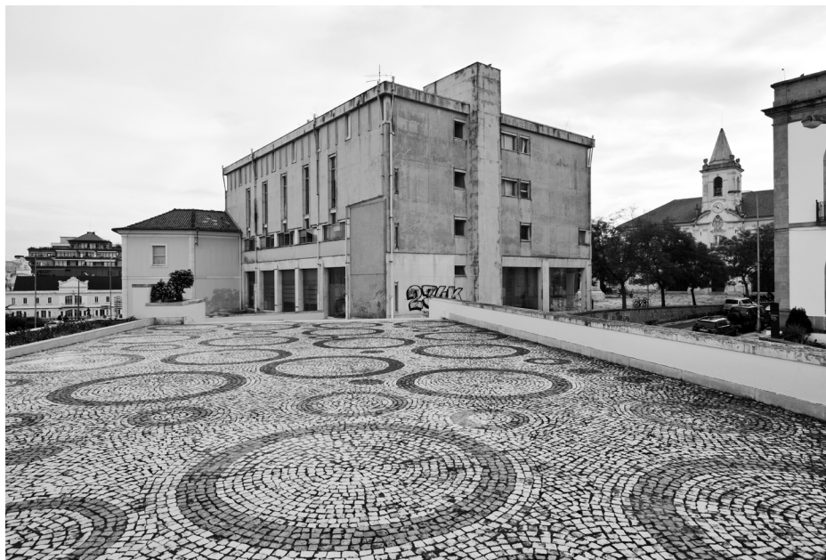
Vista nordeste do edifício municipal antes das obras de requalificação. Ainda apresentava a ferida exposta na fachada norte, por falta de encosto do bloco não construído
