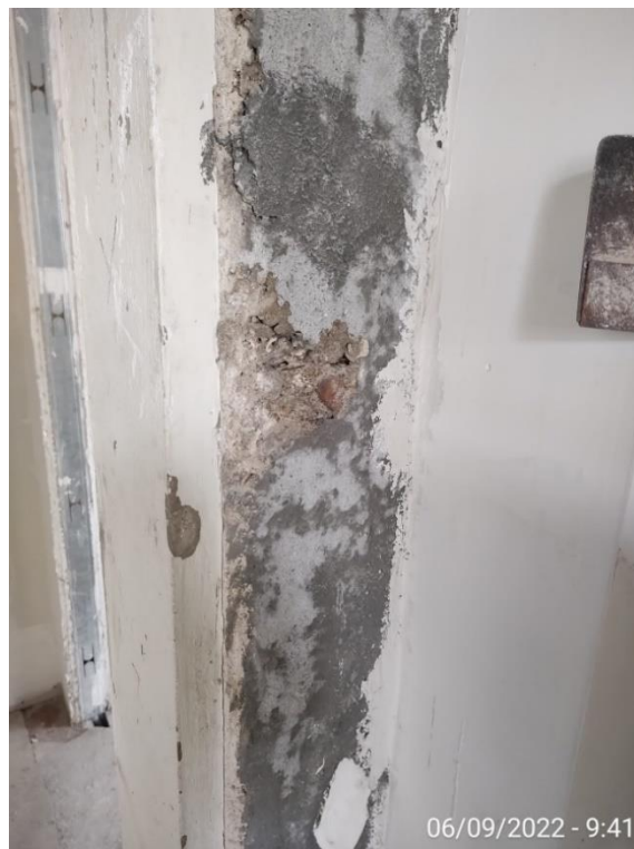
Pilar desgastado para inspeção do betão existente
