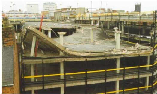
Figura 2 - Colapso parcial do 4.º piso de um parque de estacionamento em Wolverhampton, Reino Unido [5].
