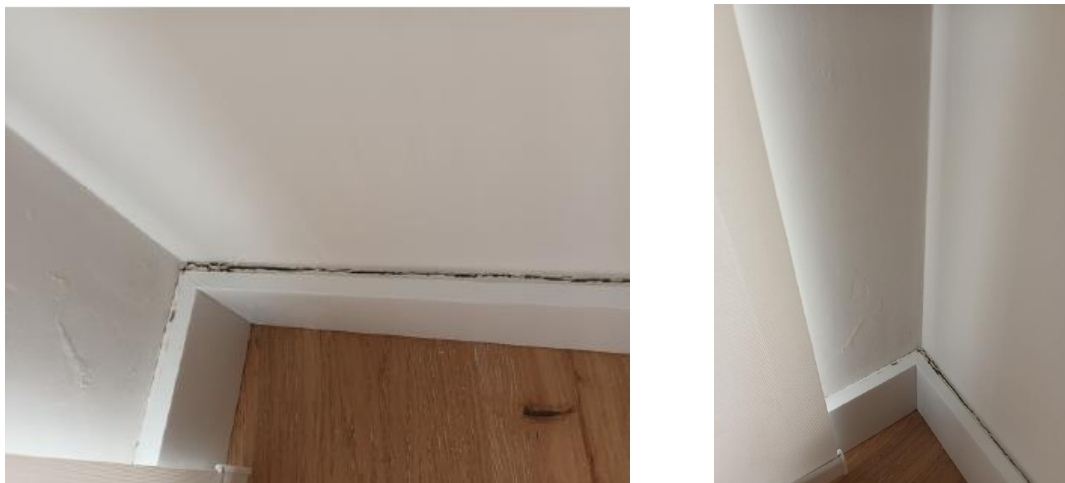
Figura 12- Infiltração na parede interior com floreira na parte exterior
