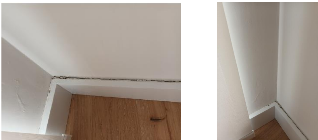
Figura 16-Infiltração na parede interior P4
