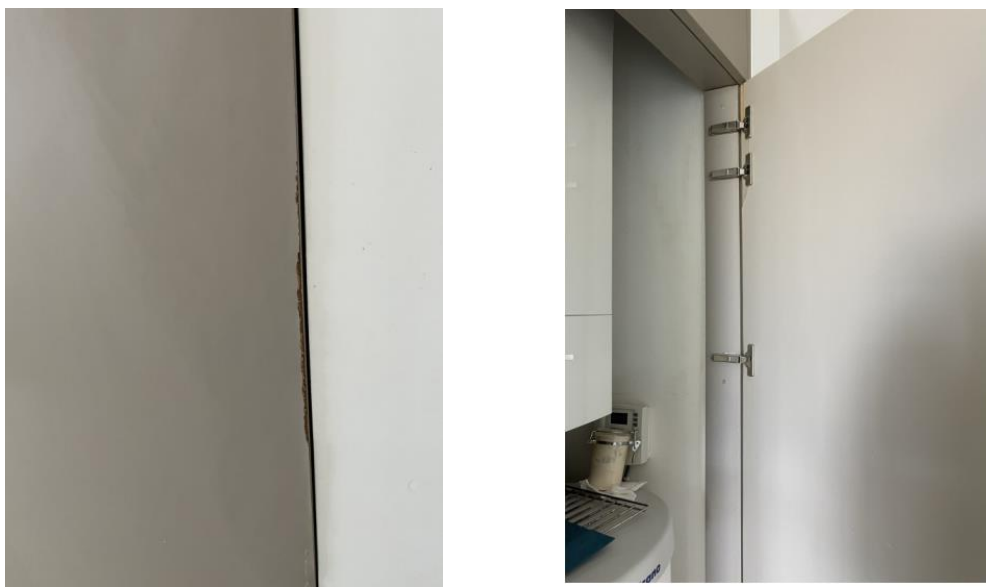
Figura 14- Armário da caldeira danificado
