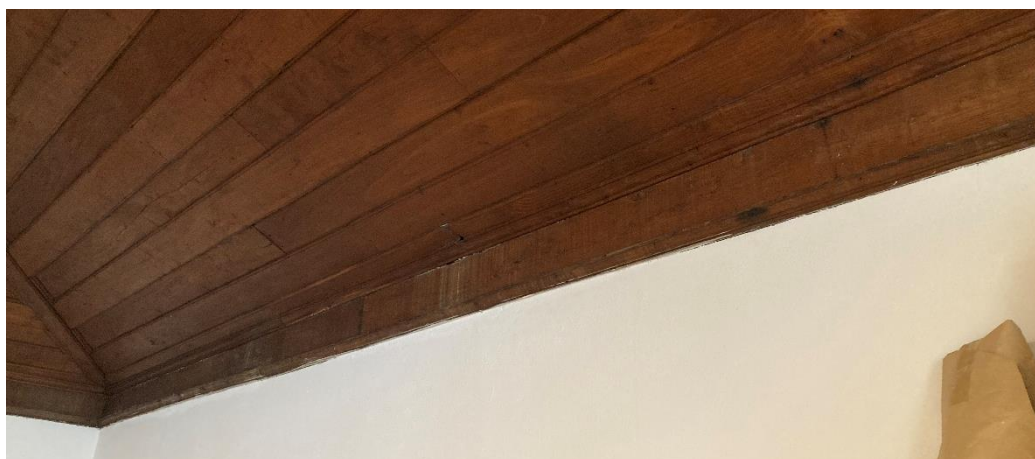
Figura 10 – Pormenor do teto da reserva da Igreja de Santa Clara do Porto. Exemplo de evidências de infiltrações. © Diana Ribeiro, 2022
