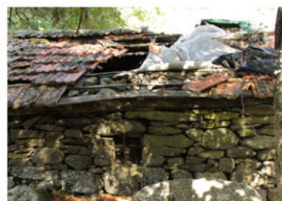
170. Estado da cobertura do moinho
