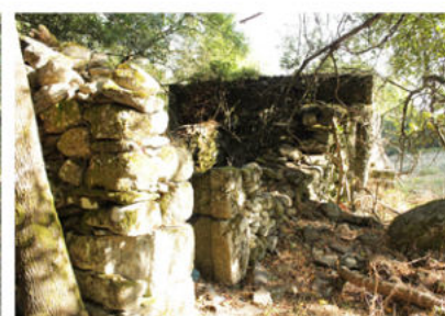
145. Estado de conservação do alçado este
