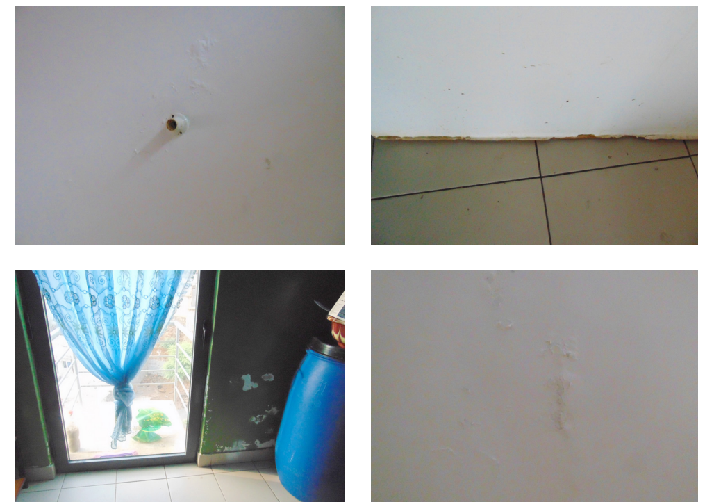
fig. 169 a 172 - Danos visíveis em apartamento Classe A.
