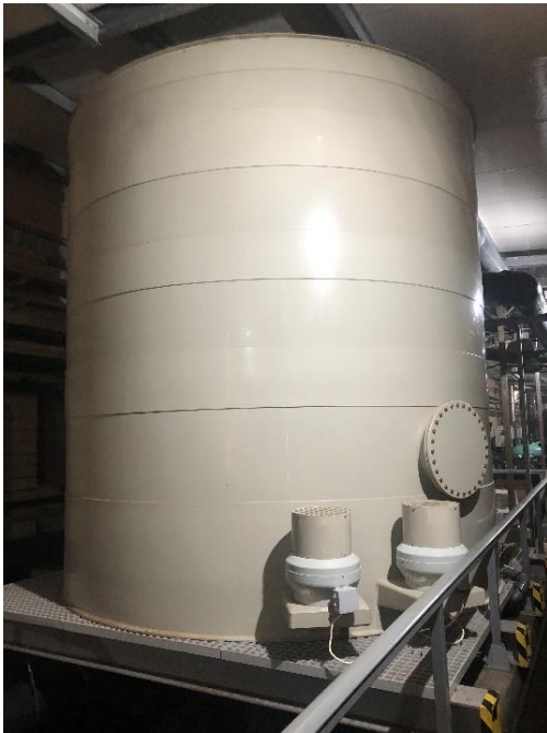
Figura 30 - Torre de desgaseificação
