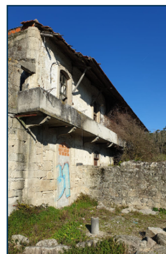
Fig. 43 - Edifício vandalizado em Retorta
