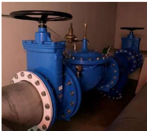
Figura 2. 20 – Válvula altimétrica do Reservatório dos Congregados, no Porto.
