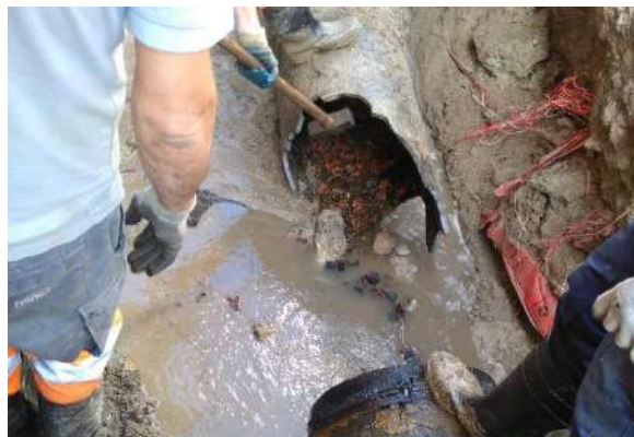
Figura 3. 3 – Rotura numa conduta adutora no Porto (AEdP, 2019).
