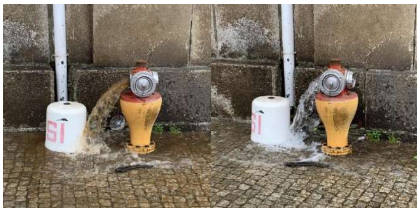
Figura 6. 8 – Exemplo de descarga controlada de um marco de incêndio localizado num troço “sem saída”, na AEdP.
