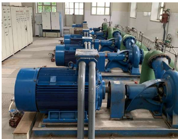
Figura 2. 8 – Grupos eletrobomba da Estação Elevatória de Santo Isidro, no Porto (atualmente fora de serviço).
