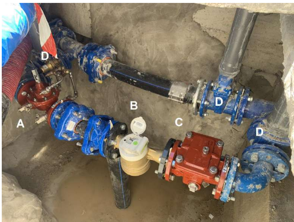
Figura 3. 8 – VRP instalada na Rua de D. Hugo, no Porto (A – VRP; B – Caudalímetro; C – Filtro do tipo H; e D – Válvulas de seccionamento).
