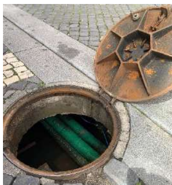
Figura 2. 21 – Câmara de manobra na Rua do Cativo, no Porto.
