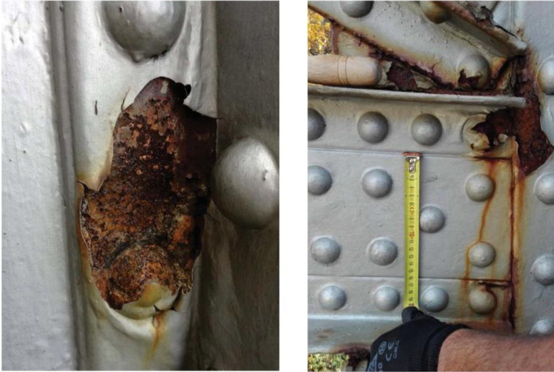
Figura 7 - Pontos com necessidade de substituição de rebites
