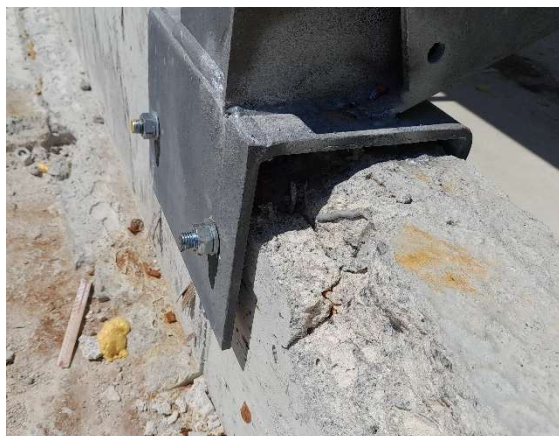
Figura 4.26 – Superfície de betão danificada junto à estrutura metálica
