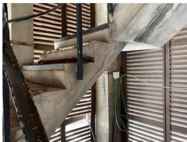
Figura 3.6 – Fissuração na escada interior de acesso
