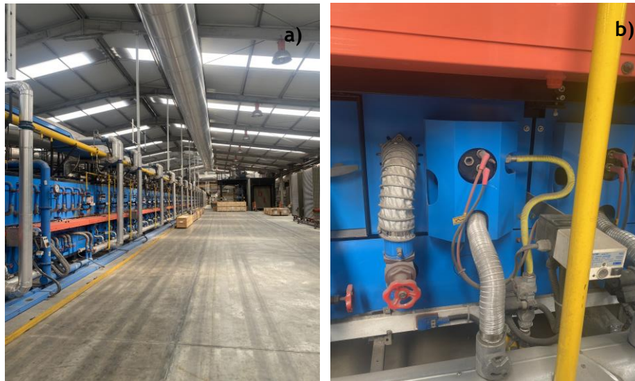
Figura 5- a) Imagem da fornalha para produção de cerâmica da empresa contactada b) Imagem detalhada de um dos injetores localizados ao longo da fornalha.
