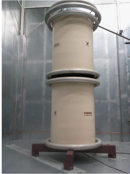
Figura 2.8 - Transformador do LAT
