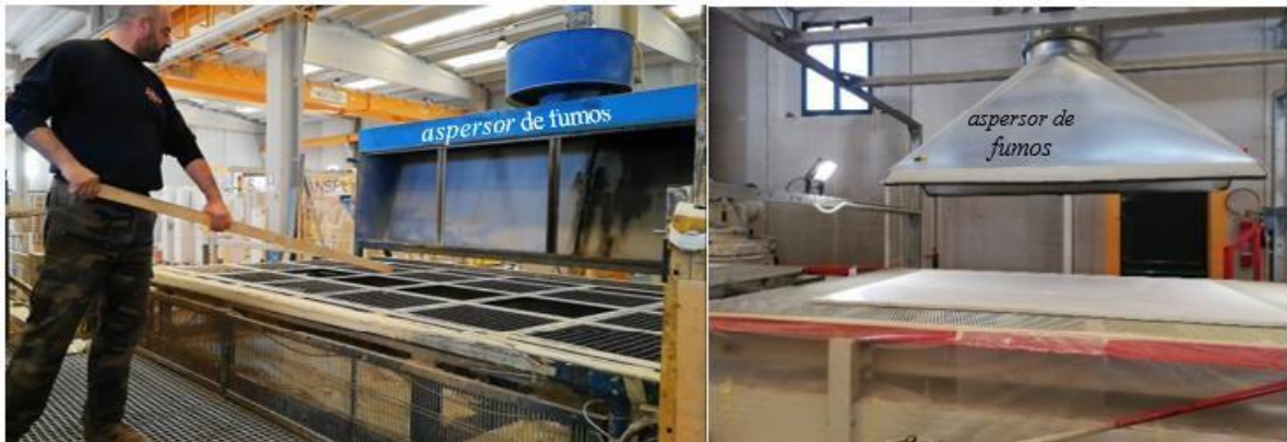
Figura 39. EPC na resinagem: aspersores de fumos.
