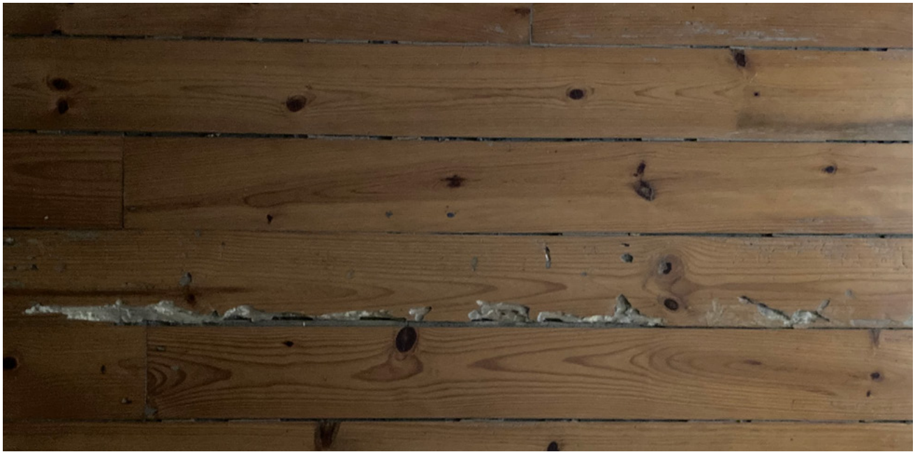
Aproximações - Qualidades e Problemas. Ambiente dos quartos. Texturas e cores. Soalho danificado
