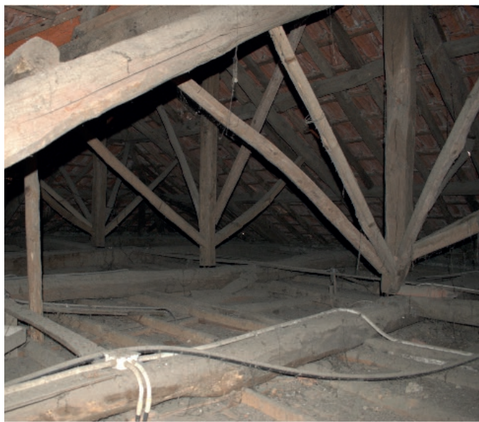
Fig.42. Estado de conservação da cobertura casa em alvenaria.
