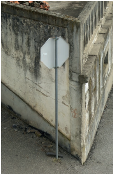
Fig.34. Blocos de cimento com humidade. Alçado oeste.
