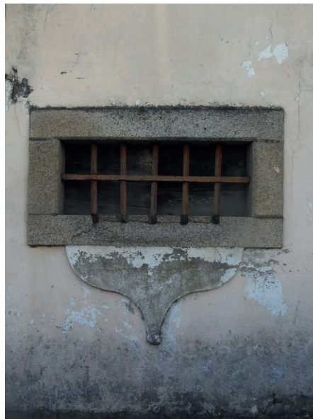
Fig.44. Oxidação da grade em ferro. Alçado este, piso 0.
