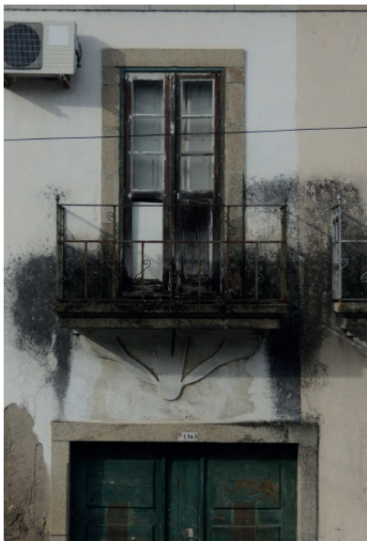
Fig.32. Humidade na janela de sacada. Alçado este.
