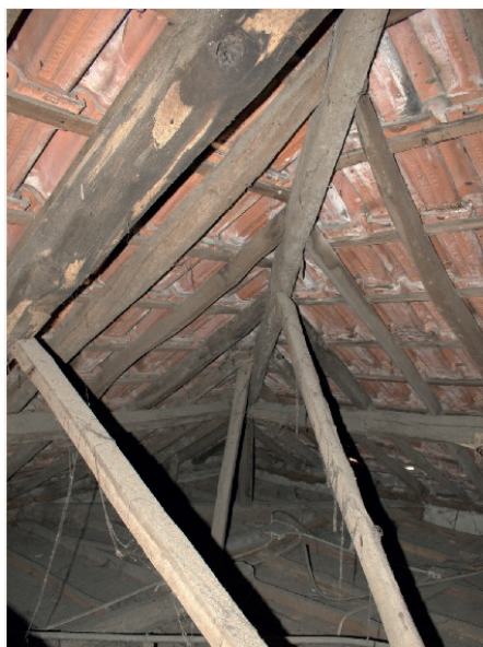
Fig.40. Estado de conservação da cobertura.
