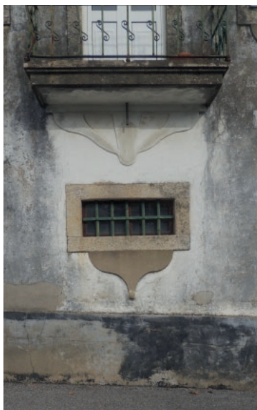
Fig.33. Desgaste superficial da pintura e argamassa. Alçado sul.
