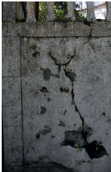
Fig.35. Fendilhação e humidade. Alçado este interior.
