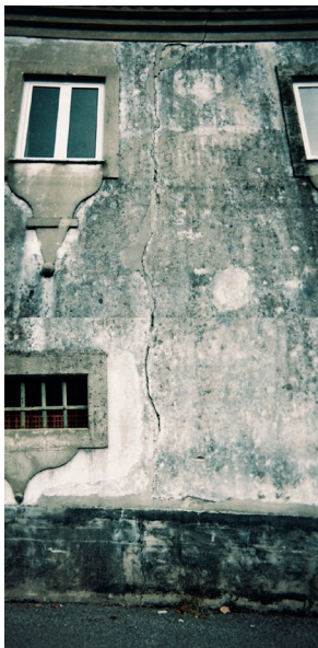
Fig.31 Fendilhação. Alçado sul.
