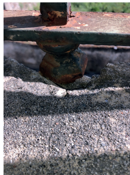
Fig.45 Oxidação da guarda de ferro.
