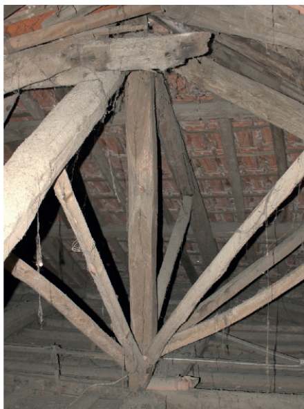
Fig.41. Estado de conservação da cobertura casa em alvenaria.
