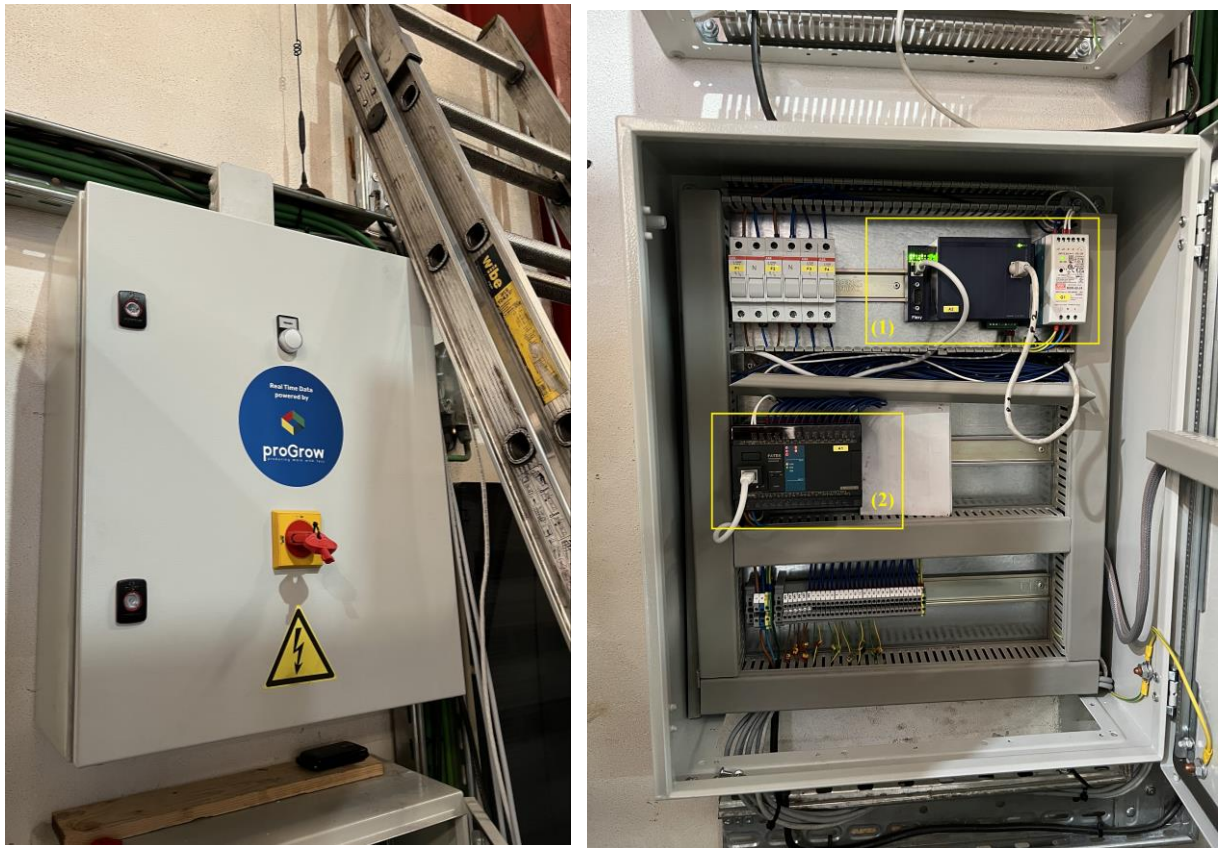
Figura 4.2 – Quadros elétricos instalados no chão de fábrica para captação de sinais das máquinas
