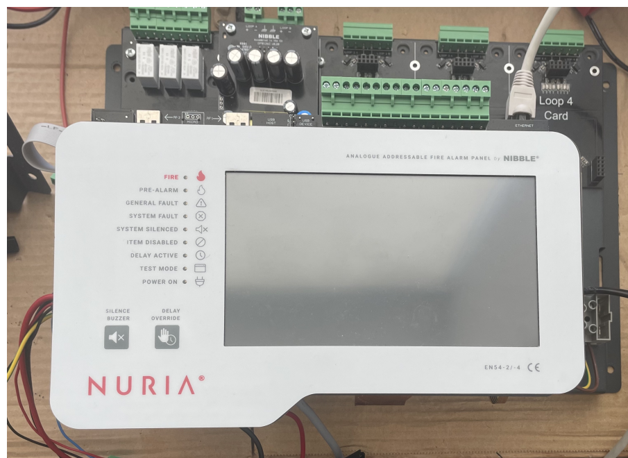
Figura 5.4: Central endereçável de detecção de incêndio NURIA.
