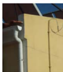
OBSTRUÇÃO DE CALEIRAS
