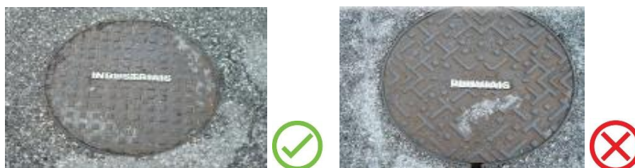
Fig. 76 – À esquerda caixa de águas industriais/residuais, à direita caixa de águas pluviais. (Fonte: Documentação Colep Packaging)
