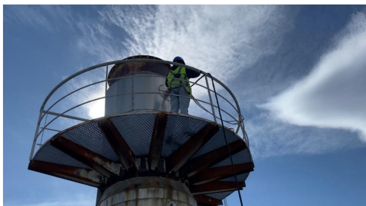
Fig. 44 – Medição de emissões atmosféricas.
