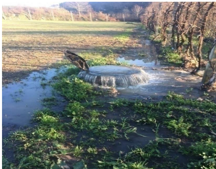
Figura 33 – Extravasamento no interceptor do Selho-Prolongamento [17]
